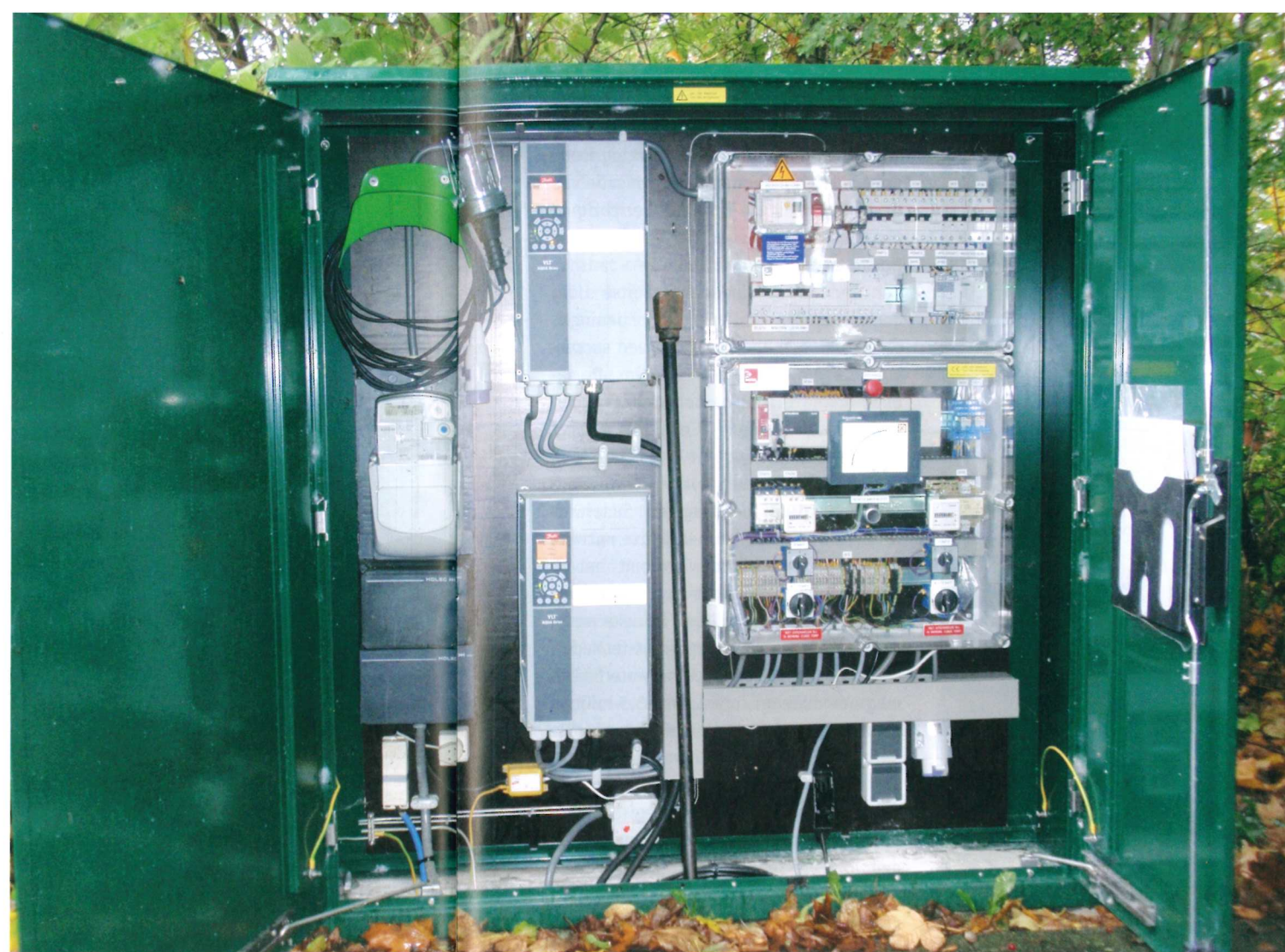
Gemeente Groningen maakt sinds enige tijd gebruik van een gebruiksvriendelijke frequentieregelaar voor rioolpompen.
